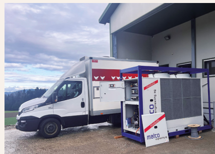
La nouvelle installation de refroidissement pour refroidir l'IRM.
