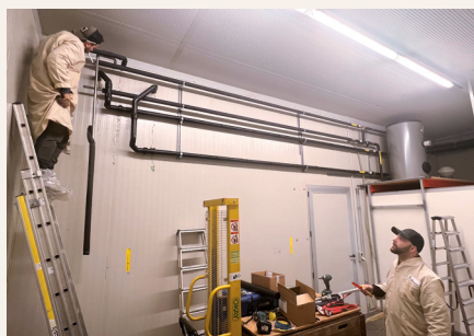
De nombreux câbles ont été déplacés et placés dans de nouvelles gaines.
